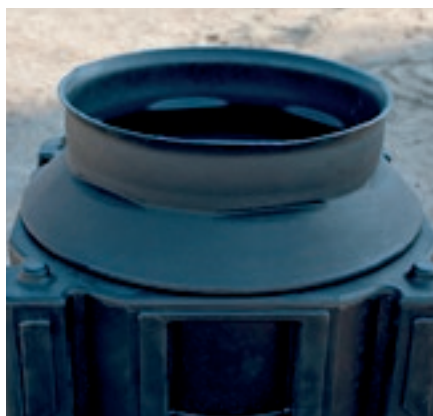
Šachta bez poklopu pro dobu výstavby
