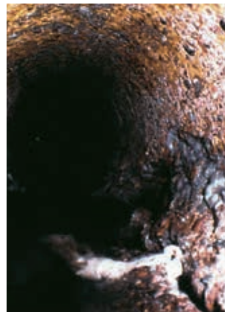
Betonová trouba se škodami způsobenými korozí
